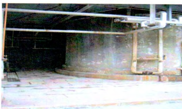
检修余料储存罐
