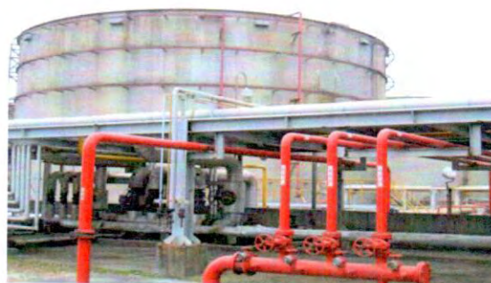
罐区泡沫系统（红管）
