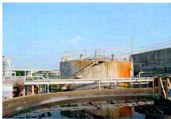
厌氧池沼气收集罐
