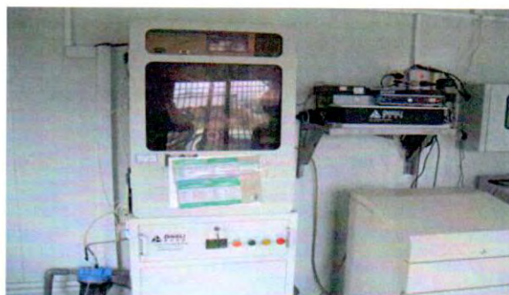
废水 COD 在线监测装置
