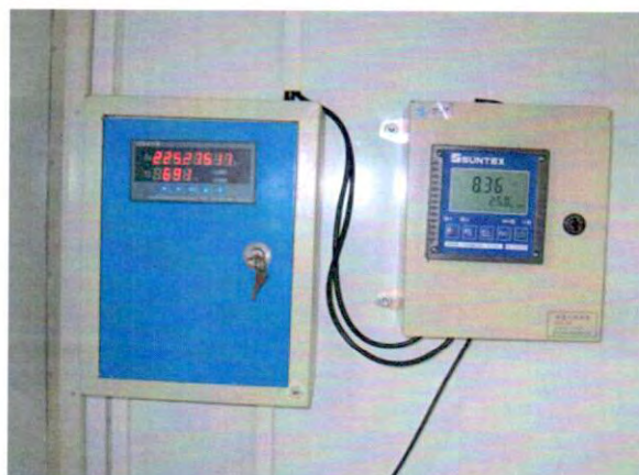
废水流量、PH 在线监测装置
