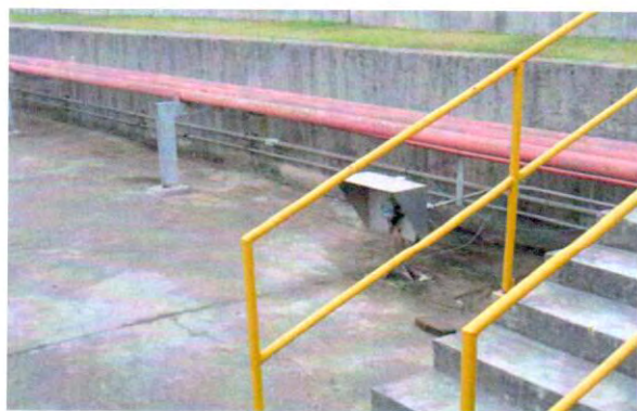
罐区可燃气体监测仪
