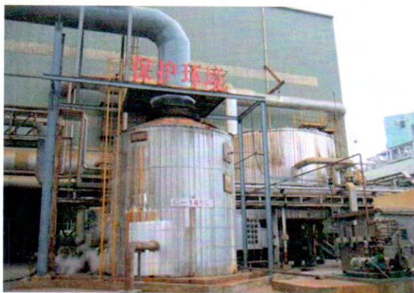
RTO 尾气碱洗罐
